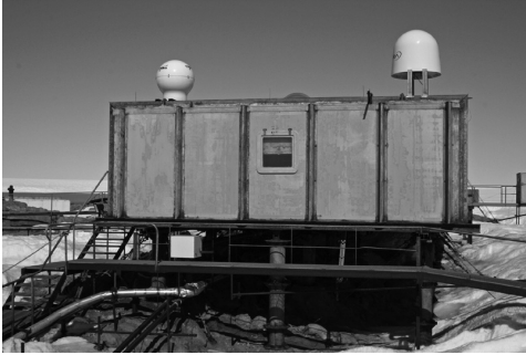
Photographie de gauche: bâtiment 26, labo 2, 2007 Photographie de droite: sauvetage du même bâtiment en 2009 : étanchéité en bardage suite à de nombreuses fuites, STATION DUMONT D'URVILLE
